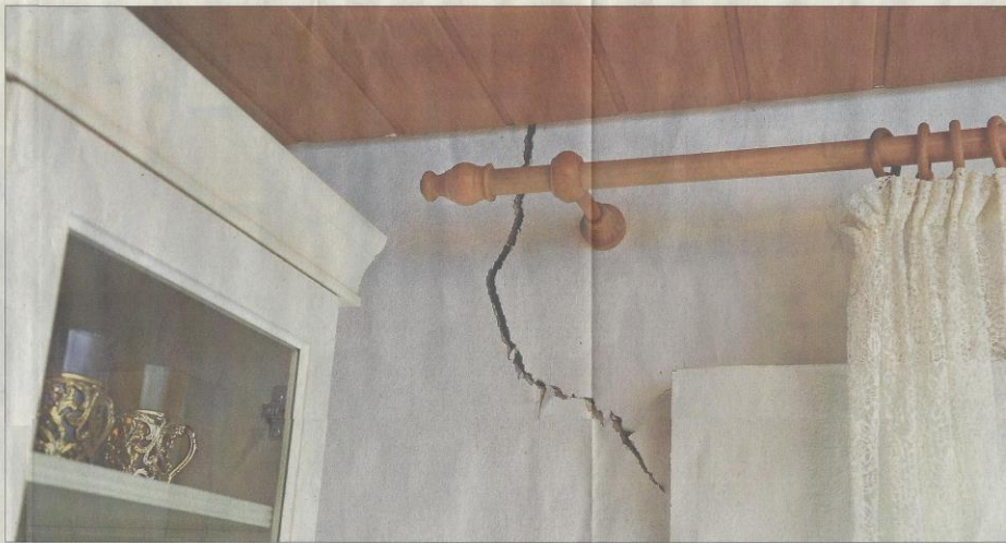
Dicke Risse in der guten Stube: So sieht ein Böblinger Wohnzimmer aus, wenn das Haus von den Erdhebungen heimgesucht worden ist.
