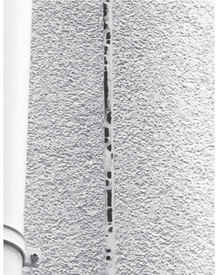
Durch Erdhebungen am Haus gerissene Dehnfuge
