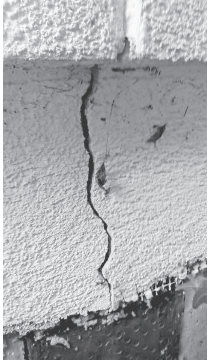
Schadensbild aus Erdhebungen
