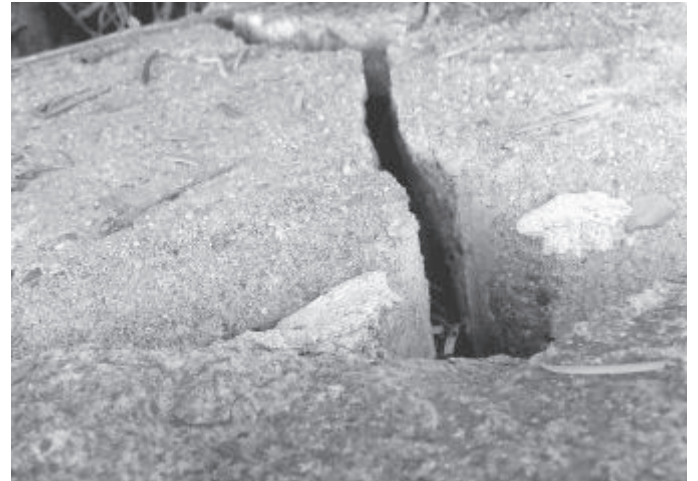
Risse in Betonmauern und Wänden
