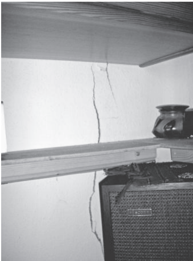
Risse in der Kellerwand Foto: Familie Binder, Böblingen
