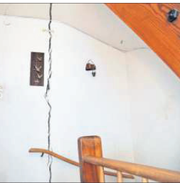
Risse durch das ganze Haus: Die Erdhebungsfolgen sind offensichtlich. Foto: Thomas Bischof
