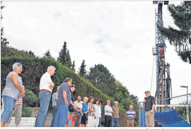
Die Sanierung der defekten Geothermiebohrungen sind abgeschlossen, der Streit um die Entschädigung der Betroffenen sorgt für Wirbel. Foto: src
